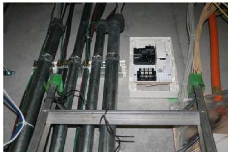
太陽光電池専用ブレーカー
